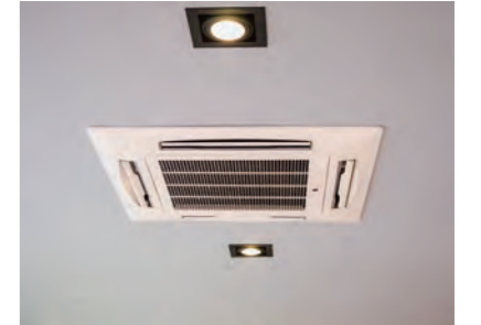
高効率の生産・空調機器への更新
