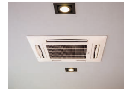
高効率の生産・空調機器への更新
