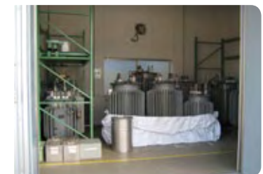
本社・横浜事業所に移設集約した PCB 保管室
