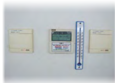
室温を見ながら温度管理者が空調機を調整します
