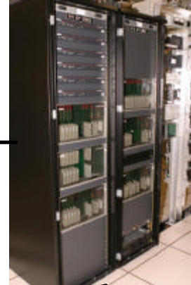
Zetron社製 基地局 コントローラー
